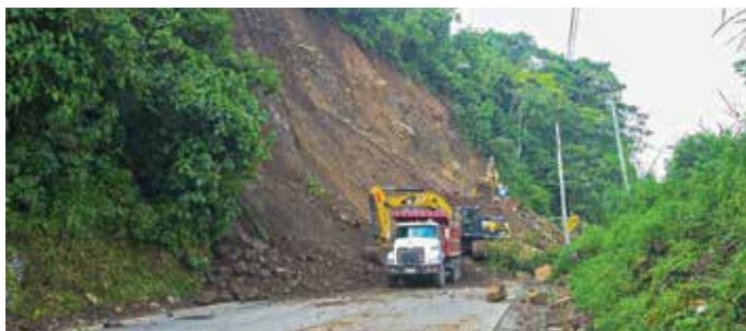
Derrumbe en vía Balbanera - Pallatanga.
