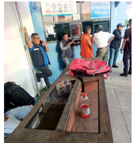
Arribo internacional con muebles viejos, sin vidrio.
