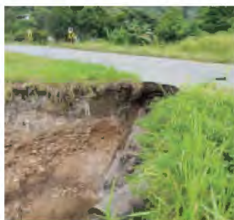
El socavón tramo Cube-Chucaple.
