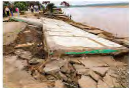
El muro colapsó en Puerto El Carmen.
