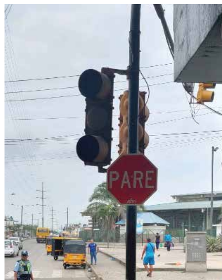
Semáforo sin energía eléctrica.
