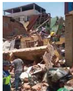
Daños por el terremoto.
