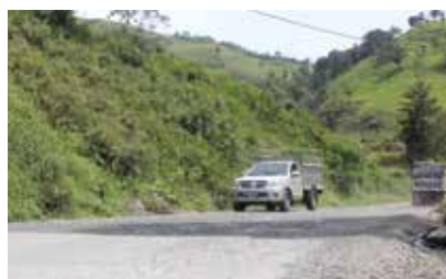
Desperfecto en la vía Balbanera – Pallatanga – Cumandá.
